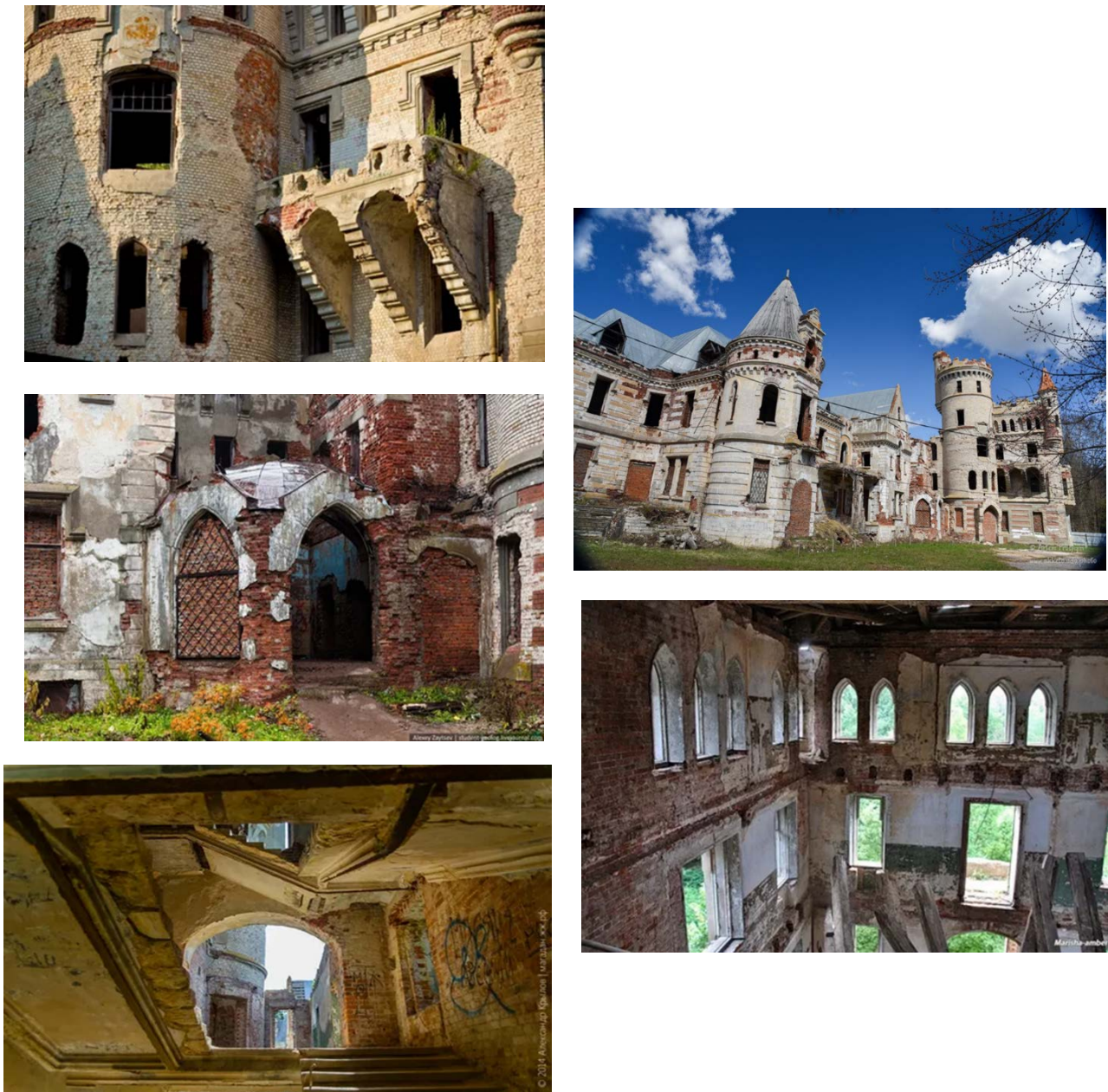
Рисунок 4 – Разрушение стен, кровли и перекрытий замка
